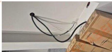
Фото 15. п.17 ВД — электромонтажные работы не завершены, кабель вывески не подключён
