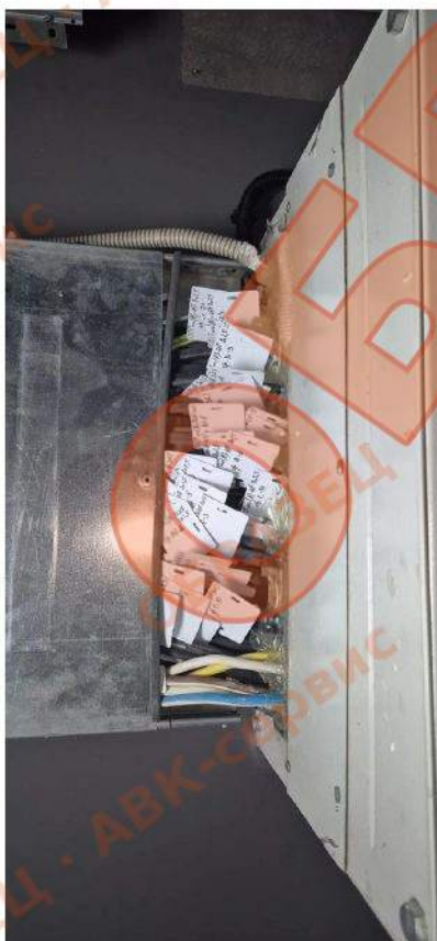
Фото 21. п.20 ВД — строительный мусор на щите
