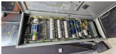
Фото 18. п.18 ВД — в щите ВРЩ не установлены автономные устройства пожаротушения АСТ 60
