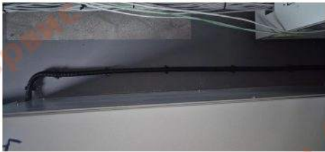
Фото 10. п.8 ВД — электропроводка в трубе ПНД, поддерживающей горение
